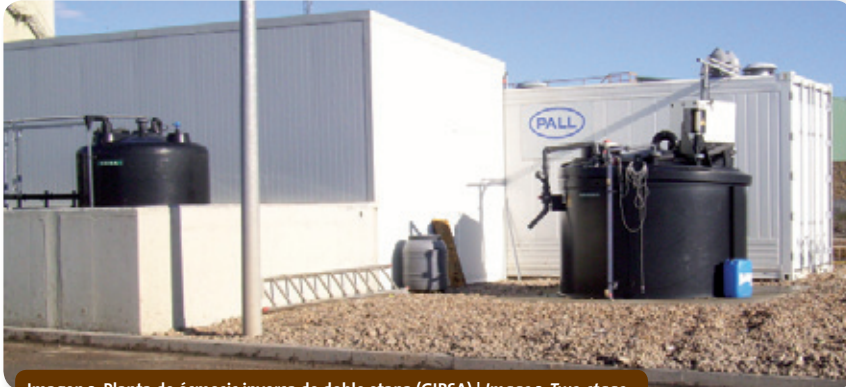
Imagen 3. Planta de ósmosis inversa de doble etapa (GIRSA) | Image 3. Two-stage reverse osmosis plant (GIRSA)
